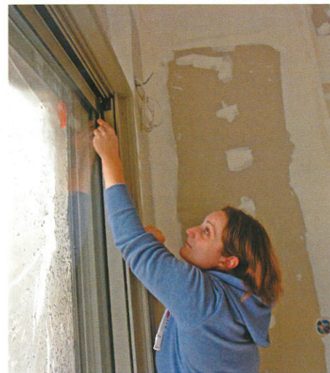
Le stylo à fumée révèle une fuite en haut du coulisant double vitrage.
