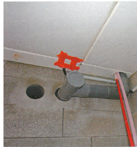
Correction d'évacuation des toilettes un peu rapidement réparée !
