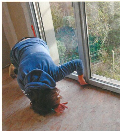
Légère fuite identifiée sous les fenêtres de l'étage, en cause le plancher bois qui a travaillé.
